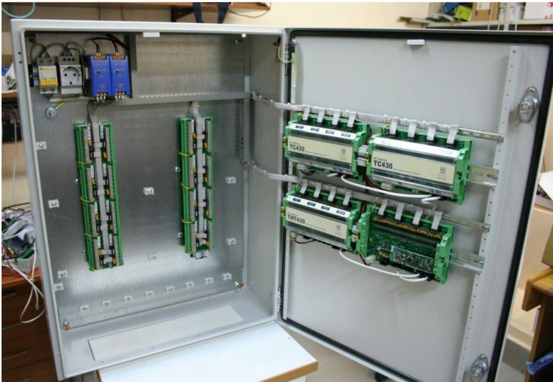
Настенный шкаф КП «Исеть» с открытой дверцей
